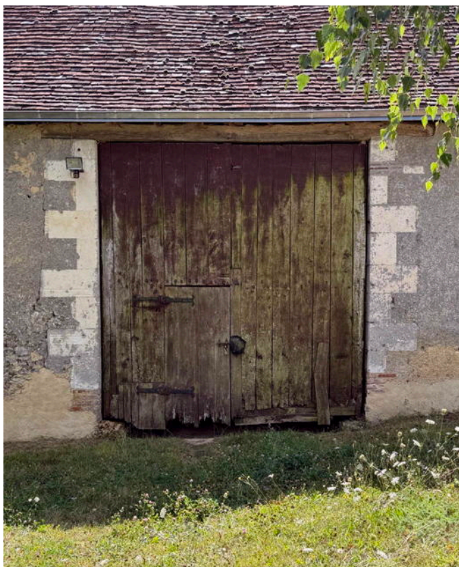
IMAGE 1 – Vue de l'extérieur
